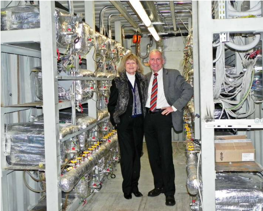
Inge und Adolf Schneider im Industrie-Container, in dem 50 E-Cats zu je 20 kW mit zusätzlichen Reserve-E-Cats eingebaut sind. Die hier gezeigte 1-MW-Anlage war das erste Grosssystem, das letztes Jahr am 28. Oktober vorgestellt und inzwischen nach einigen technischen Optimierungen an den ersten Kunden ausgeliefert wurde.
